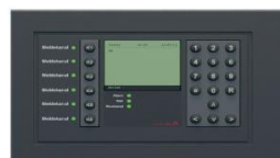
System sygnalizacji pożaru (FAS)
